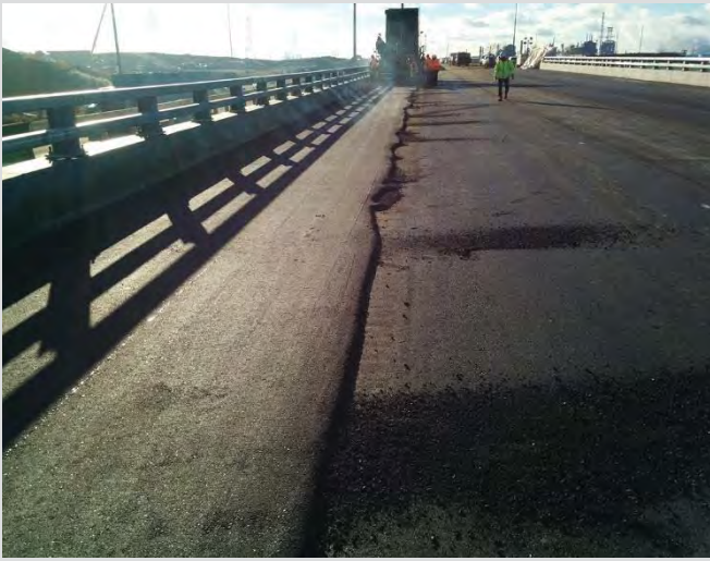
17.9 Unacceptable, uneven longitudinal joint.
